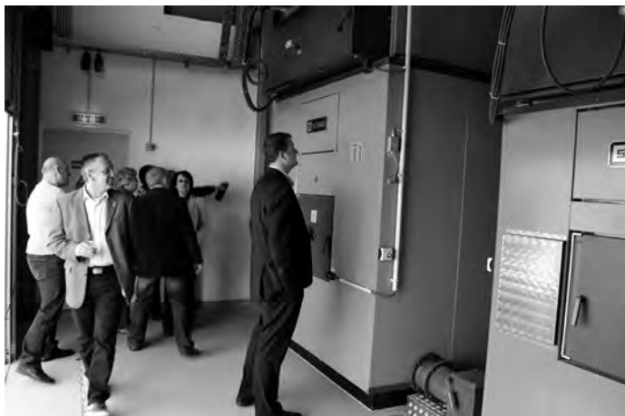
Interessiert schauten sich die Gäste die neuen Heizkessel an, die mit Holzschnitzel bestückt werden und mit einer modernen Computeranlage gesteuert werden.
