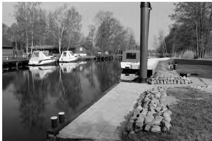
Die Anlegestelle wurde durch die Vereinsmitglieder des Kahnschifferzentrums in eigener Regie ohne finanzielle Förderungen und Zuschüsse Dritter gebaut.
